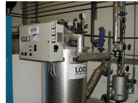
Firmeneigene Dampfkesselanlage mit einem max. Druck bis 16 bar zur Überprüfung der Gebrauchsmaschinen
